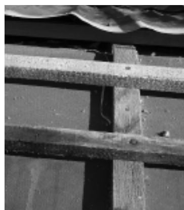
Fot. 1. Pod blachodachówkami bez wentylacji (tak jak na fotografii 2), uszczelnionymi MWK, po okresie 3 – 4 lat większość łąt znajdujących się pod kalenicą ma spróchniałe miejsca, które powstają przede wszystkim pod wkrętami mocującymi („farmarami”).
