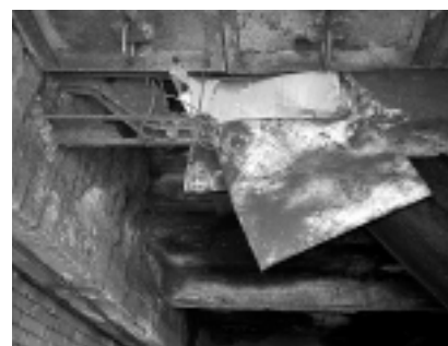
Fot. 1. Istniejąca „odkrywka” w żelbetowym żebrze stropu budynku sortowni
