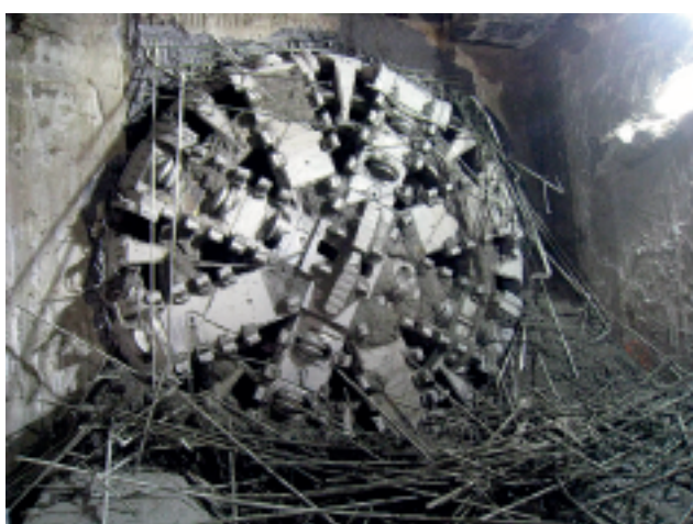
Fot. 5. Głowica tarczy EPB po wykonaniu 800 m tunelu i przejściu przez ścianę szczelinową stacji „Świętokrzyska” – widoczny stopień zużycia narzędzi skrawających
