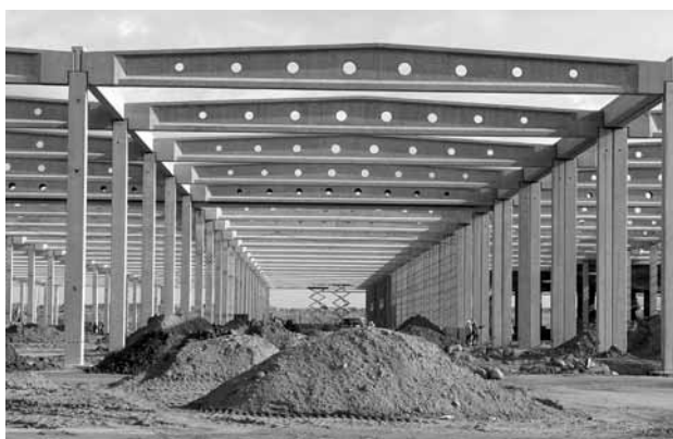
Zastosowanie dwuteowych dźwigarów dachowych, zmiennej wysokości (SI-500/1650/20,6), długości 20,6 m w nowo budowanym zakładzie produkcyjnym Indesit w okolicy Radomska
