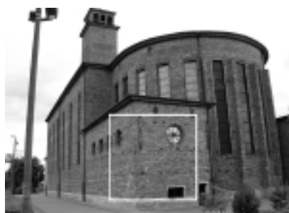
Fot. 1. Kościół z zaznaczonym obszarem przemieszczeń Photo 1. Church with marked area of displacements
