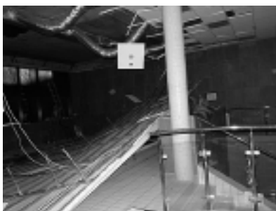
Fot. 1. Sufit podwieszony, który spadł do niecki basenu
