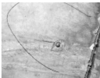
Fot. 2. Widok pozostałości łącznika Koelner w suficie
