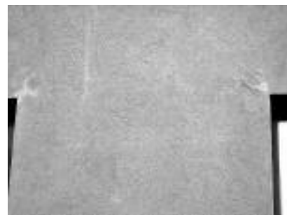
Fot. 2. Ukośne zarysowania na tynku w narożach otworów okien
