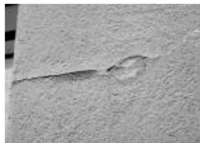
Fot. 1. Pęknięcia z przerwaniem ciągłości tynku
