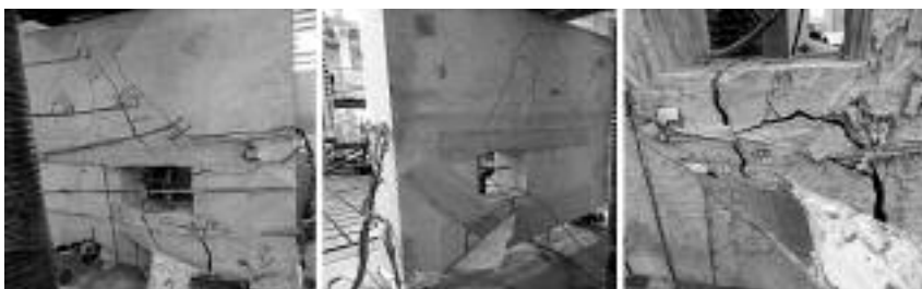
Fot. 2. Obraz zniszczenia tarczy wzmocnionej siatką z włókien PBO Photo 2. The failure view of deep beam strengthened with the PBO mesh
