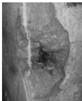
Fot. 1. Brak pręta w narożniku słupa
