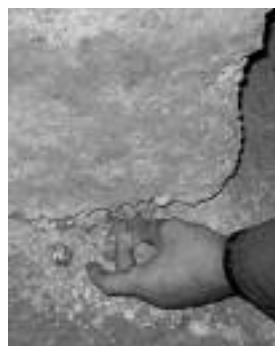
Fot. 2. Zła jakość betonu przy podstawie słupa
