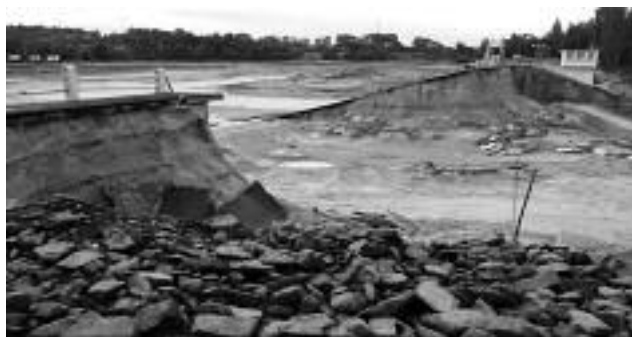
Fot. 1. Rozmycie prawej strony zapory [2] Photo 1. Washout of the right side of the dam [2]
