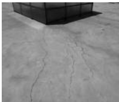
Fot. 2. Rysy na płycie zbiornika od strony wschodniej
