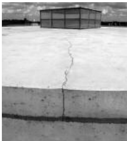
Fot. 3. Jedna z rys od strony południowej widoczna na płycie oraz na jej obwodzie
