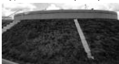
Fot. 1. Zbiornik o średnicy wewnętrznej 16 m, wyniesiony ponad teren i obsypany gruntem Photo 1. Tank with an inner diameter of 16 m, elevated above ground and showered ground
