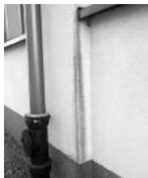
Miejsce spływu wody z parapetu
