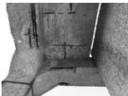
Fot. 2. Typowe uszkodzenia płyty stropowej i belek
