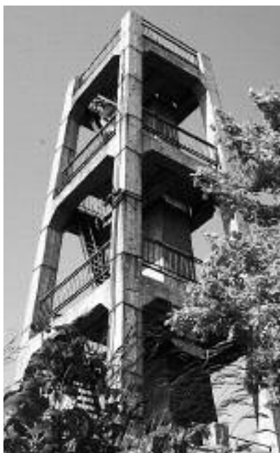
Fot. 1. Widok ogólny wieży żelbetowej Photo 1. General view of the reinforced concrete tower
