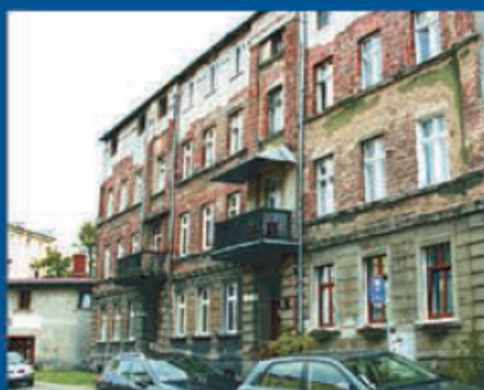
Budynek przed osuszeniem – Jelenia Góra
