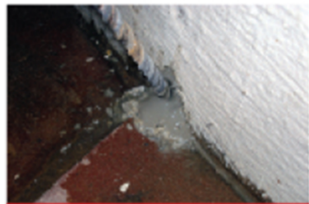
Fot. 3. Odwiert na połączeniu odsadzki betonowej z posadzką w miejscu występowania przecieków
