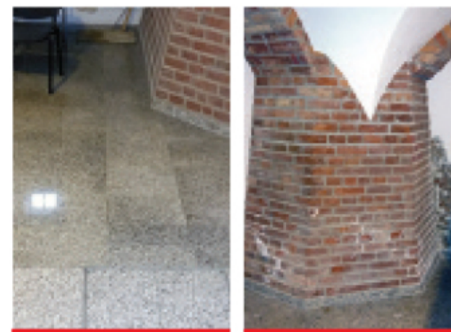
Fot. 1. Posadzka z płyt granitowych – widoczne przebarwienia w wyniku zawilgocenia, brak kanałów instalacyjnych
