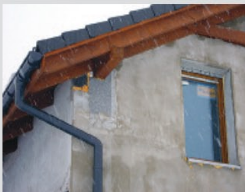
Fot. 4. Wycieki pod belkami są efektem działania przewiewów i nie mają nic wspólnego z pokryciem dachu. W szczelinach, gdzie jest przewiew – przepływa powietrze wewnętrzne, a para wodna wykrapla się również na stronę poddasza. W tym budynku płyty g-k były miejscowo mokre
