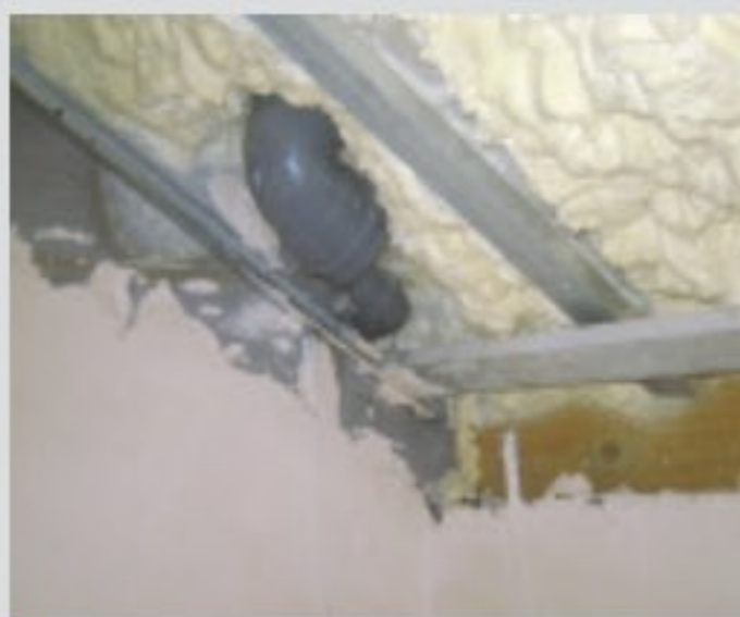
Fot. 5. Wnętrze tego samego budynku, jak na fotografii 4. Wskutek niestarannego natryśnięcia piany PUR (2013 r.) powstało wiele szczelin na połączeniu piany z murami i belkami więźby. W tych miejscach tworzyły się przewiewy, a ich konsekwencją było powstanie kondensatu, który spowodował zalanie płyt g-k we wnętrzu oraz tynku na elewacji
