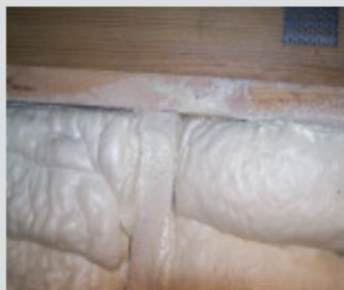
Fot. 6. Natryskowa piana PUR jest szczelna dla powietrza, ale takie jej ułożenie, które wypełni wszystkie szczeliny w przegrodzie, nie zawsze jest możliwe. Drewno stale zmienia swoją objętość i odkształca w zależności od zawilgoce, a piana ma bardzo dużą rozszerzalność termiczną
