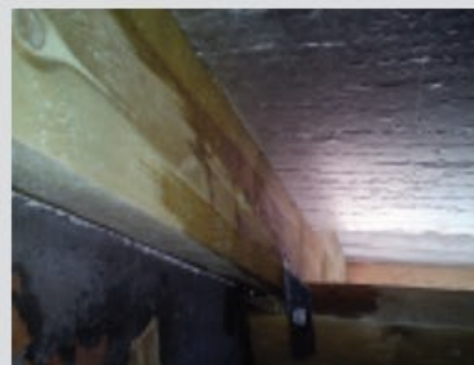
Fot. 2. Dach z fotografii 1. Wszystkie krokwie są mokre w takim samym stopniu i czym bliżej okapu, tym wody na nich jest więcej. To jeden z dowodów na to, że woda jest kondensatem pary wodnej zawartej w powietrzu, a nie przeciekiem przez wkręty montażowe. Na płytach jest MWK dociśnięta kontrłatami
