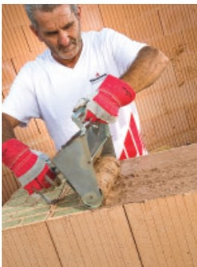
Fot. 2. Nakładanie cementowej zaprawy do cienkich spoin Porotherm Profi na warstwę muru z pustaków ceramicznych Porotherm T Profi
