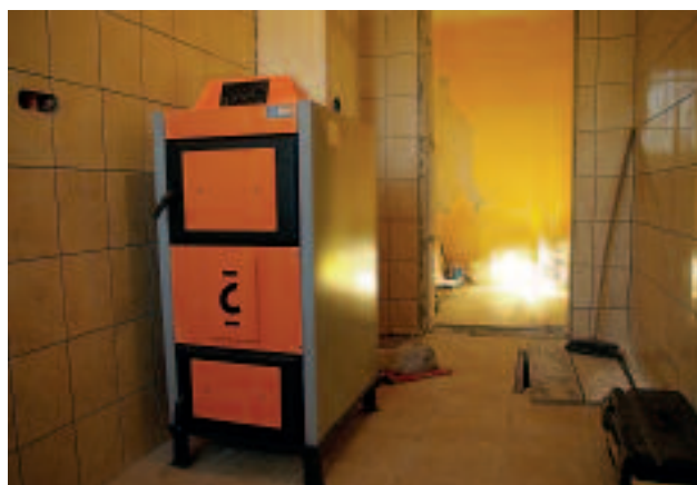
Fot. 4. Kocioł c.o. SIGMA 20 kW zainstalowany w modernizowanym budynku
