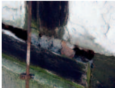
Fot. 2. Fragment oparcia słupa ściany nośnej wieży na zniszczonej podwalinie. Widoczne doraźne naprawy w postaci korka z gruzobetonu
