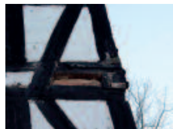
Fot. 3. Widok północno-zachodniego naroża wieży na styku dwóch członów. Wcześniej próby naprawy kłamrami zawiodły
