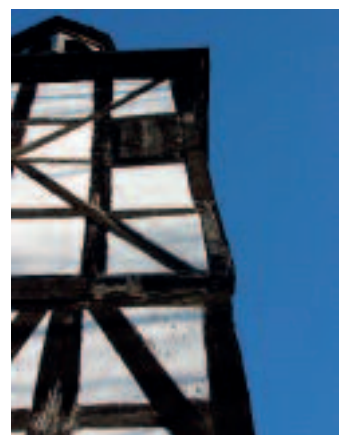
Fot. 4. Ściana frontowa wieży kościelnej (narożnik pd-zach.) – widoczne przemieszczenie drugiego członu wieży w stosunku do części przyziemia
