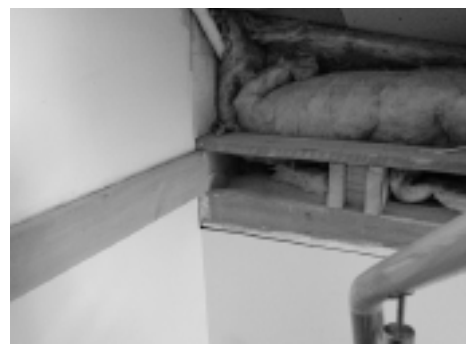
Fot. 2. Nieszczelność w obudowie analizowanego budynku
