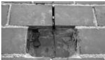
Fot. 5. Elewacja wieży – spękania obejmujące całą grubość warstwy okładzinowej oraz spękania wchodzące nieco w głąb muru Photo 5. Elevation of the tower – cracks throughout the cover layer thickness and cracks entering the wall
