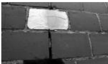
Fot. 3. Elewacja wieży – pionowe spękania badanej cegły licowej oraz ubytki spoin Photo 3. Elevation of the tower – vertical cracks of the facing brick and joint loss
