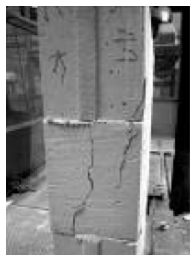
Fot. 3. Przykład zarysowania muru zbrojonego kratowniczką
