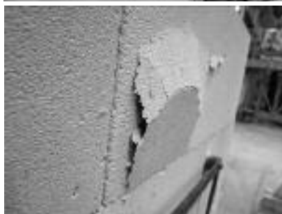
Fot. 4. Szczegóły zarysowania – mur zbrojony siatką z tworzywa sztucznego
