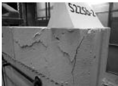
Fot. 5. Szczegóły zarysowania – mur zbrojony siatką bazaltową
