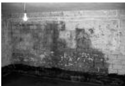
Fot. 1. Wygląd nieskutecznie zabezpieczonych przed wodą ścian fundamentowych z bloczków betonowych [Fot. archiwum Autorów]
