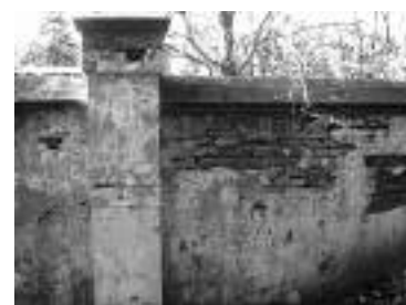
Fot. 2. Elewacja muru wskazująca na jego obecny stan techniczny Photo 2. The facade of the wall pointing to the actual technical condition
