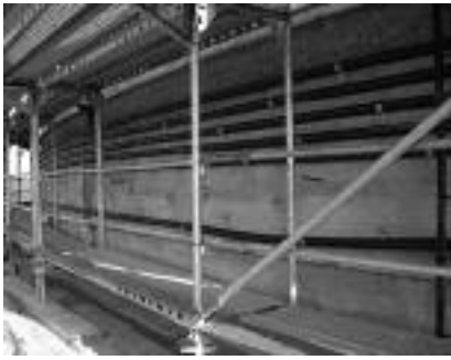
Fot. 2. Wzmocnienia dolnego wieńca rozciąganego [Fot. R. Dżugaj] Photo 2. Reinforcement of the lower extended rim [Photo R. Dżugaj]
