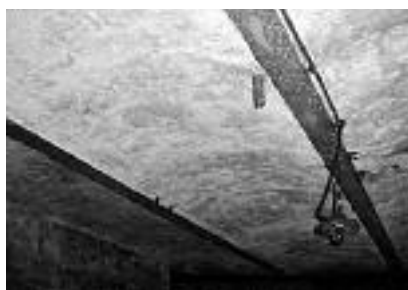
Fot. 5. Skorodowane belki stropowe w piwnicy
