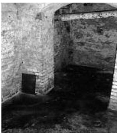
Fot. 3. Zaleganie wody na podłodze w piwnicy
