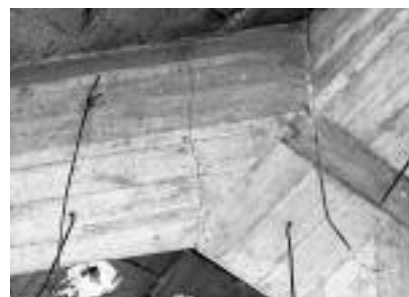
Fot. 5. Zarysowania żelbetonowych podciągów dachowych Photo 5. Cracks in roof RC main beams
