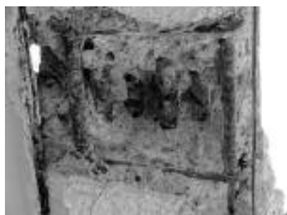
Fot. 3. Odkrywka zbrojenia podciągu dachowego Photo 3. Examination of rebars in RC roof main beam
