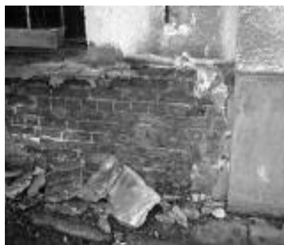
Fot. 5. Przykładowy widok uszkodzeń murów zewnętrznych budynku [Fot. Z. Matkowski] Photo 5. An example of an external wall destruction [Photo Z. Matkowski]
