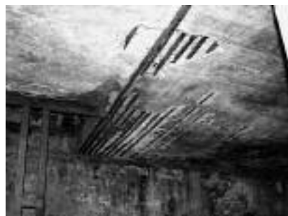
Fot. 4. Skorodowane zbrojenie płyty stropodachu części niższej hali [Fot. A. Klimek] Photo 4. Corroded reinforcement of the roof slab in the lower part of the hall [Photo A. Klimek]
