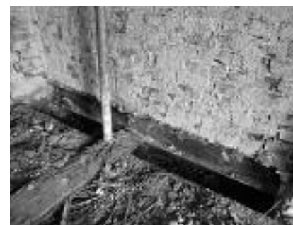
Fot. 2. Belka stalowa podtrzymująca nadwieszoną ścianę szczytową; pod belką widoczne jest przesunięcie na zewnątrz ściany szczytowej niższej kondygnacji, będącej pierwotnie ścianą sąsiedniego budynku
