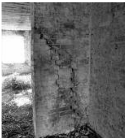
Fot. 3. Uszkodzony komin mурowany, na którym pierwotnie oparto belki stalowe, podtrzymujące nadwieszoną ścianę szczytową Photo 3. Damaged chimney, which originally supported steel beams on which the overhanging party wall was standing
