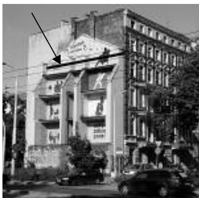
Fot. 1. Remontowany budynek z widoczną niezwiązaną z nim ścianą szczytową rozebranego sąsiedniego budynku; czarną linią oznaczono poziom uskoku (nadwieszenia) ściany szczytowej dobudowanego budynku oraz poziom istniejących belek stalowych i kratownicy wzmacniającej wg opisu w artykule
