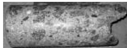
Fot. 2. Odwiert C2 – niewłaściwy dobór uziarnienia kruszywa
