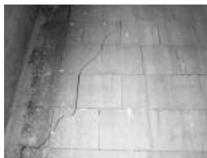
Fot. 1. Przykłady pęknięć i rys w ścianach działowych badanego budynku
