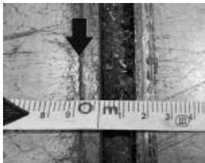
Fot. 1. Dylatacja posadzki beznacięciowej
