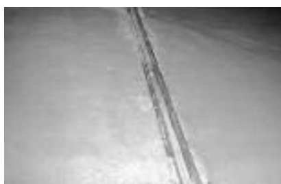
Fot. 3. Typowe wykruszenia dylatacji posadzki z płaskownikami
