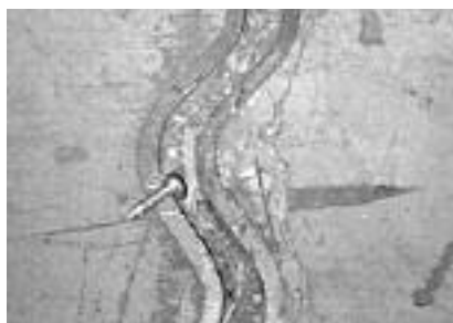
Fot. 4. Uszkodzenia pionowej dylatacji sinusoidalnej
