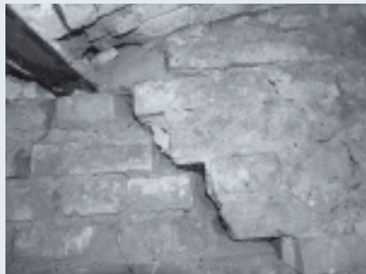
Fot. 2. Spękanie ściany poprzecznej i stropu w piwnicy [Fot. Autorzy] Photo 2. Transverse cracking of wall and ceiling in the basement
