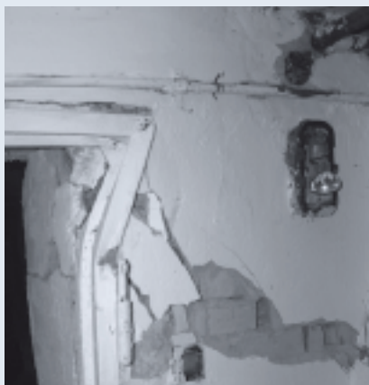
Fot. 1. Deformacja otworu drzwiowego ściany podłużnej w piwnicy [Fot. Autorzy] Photo 1. Deformation of the longitudinal wall door opening in the basement
