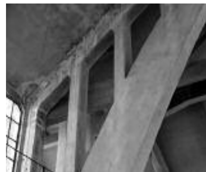
Fot. 2. Zacieki na płytach stropodachów i łukach Photo 2. Weepings on roof slabs and arch frames
