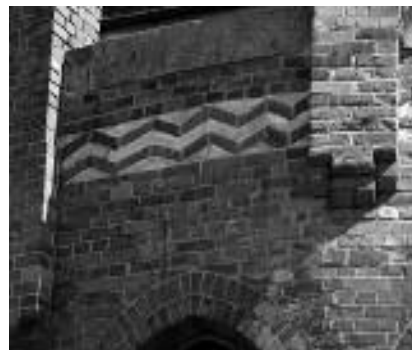
Fot. 4. Uszkodzenia murów ceglanych Photo 4. Local damages in masonry walls
