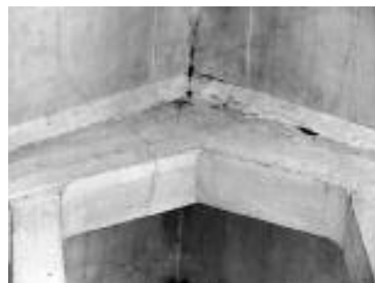
Fot. 3. Zarysowania elementów ram świetlika Photo 3. Cracks of roof window frames
