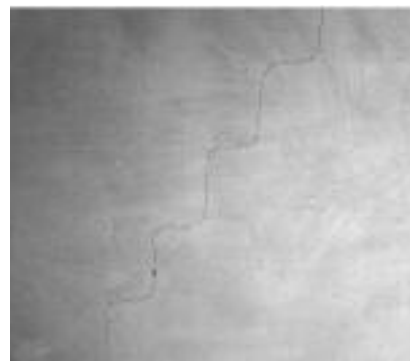
Przykład pęknięcia ścianki z bloczków silikatowych wykonanej między uginającymi się stropami
