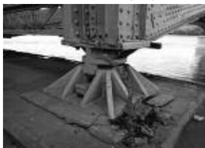
Fot. 4. Uszkodzenia łożysk mostu Legionów Józefa Piłsudskiego
