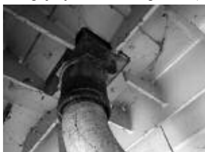
Fot. 5. Korozja wpustu odwodnienia
