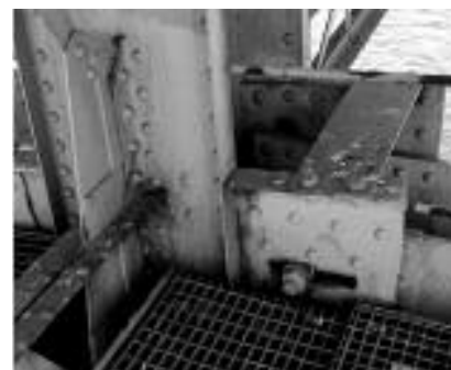
Fot. 3. Korozja przęseł kratownicowych w otoczeniu nieszczelnej dylatacji
