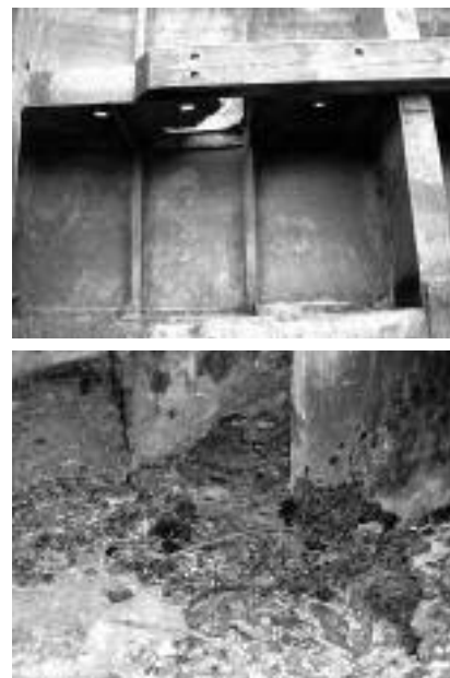
Fot. 2. Korozja elementów stalowych wrót Photo 2. Lock-gate steel elements corrosion
