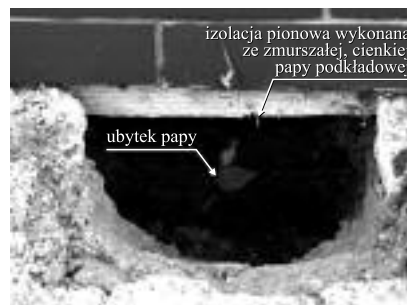
Fot. 3. Widok odkrywki ściany zewnętrznej ukazującej nieszczelną dla wody, pionową izolację przeciwwilgociową w postaci zmurszałej, cienkiej papy podkładowej
