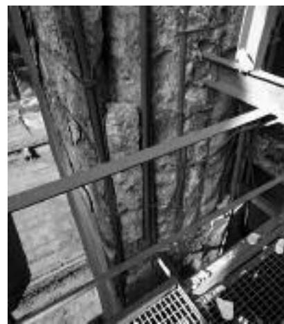
Fot. 2. Uszkodzenie słupów żelbetonowych Photo 2. Damages of RC columns
