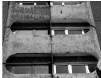
Fot. 7. Stan balustrad balkonowych portfenetrów
