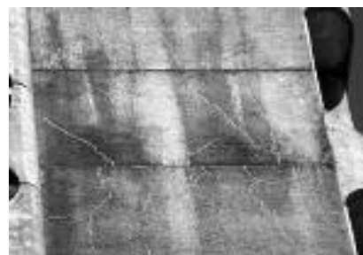
Fot. 6. Typowe uszkodzenia płyt osłonowych Photo 6. Typical deterioration of curtain walls
