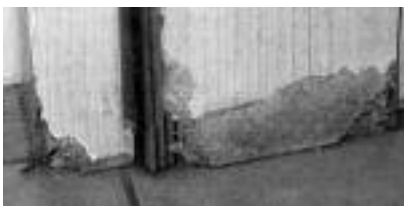
Fot. 1. Odklejanie się okleiny na drzwiach w wyniku działania wody przy myciu podłóg Photo 1. Peel a veneer on the door as a result of water used in the cleaning of floors
