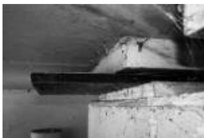
Fot. 1. Awaryjne przemieszczenia wkładki elastomerowej łożyska Photo 1. Failure displacement of a bearing pad
