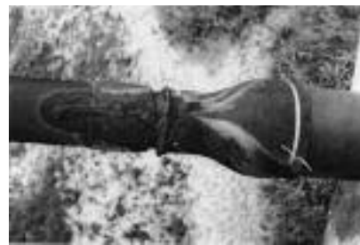
Fot. 4. Nieszczelność osłony wanty mostu podwieszanego Photo 4. Break of a stay cover in a cable-stayed bridge
