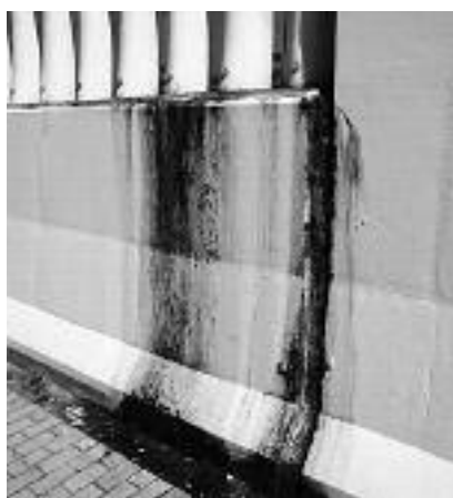
Fot. 5. Zacieki na cokołach obiektów gruntowo-powłokowych będące efektem wadliwej izolacji
