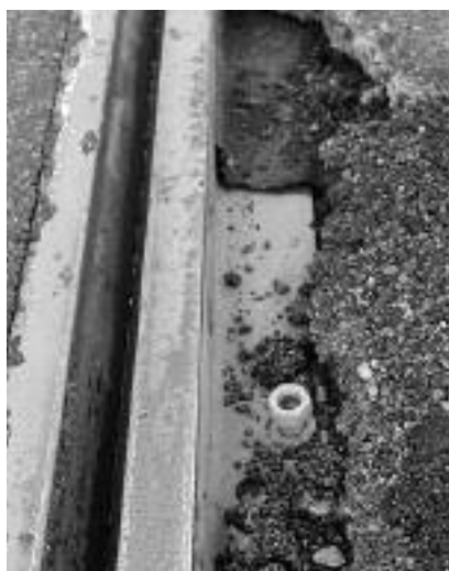
Fot. 6. Ubytek nawierzchni bitumicznej wzdłuż szczeliny dylatacyjnej
