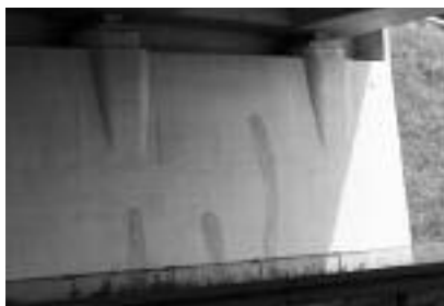
Fot. 2. Pionowe zarysowania korpusu przyczółka Photo 2. Vertical cracks of an abutment body
