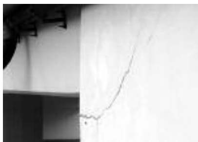
Fot. 3. Zarysowanie przyczółka obiektu zintegrowanego w strefie połączenia z przęsłem Photo 3. Crack of an integral bridge abutment at its connection with span
