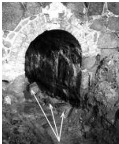
Fot. 2. Przepust kamienny – widoczne kolidujące granitowe głazy odsadzki fundamentu Fot. A. Czuchnicki Photo 2. Stone culvert – granite boulders visibly sticking out from foundation
