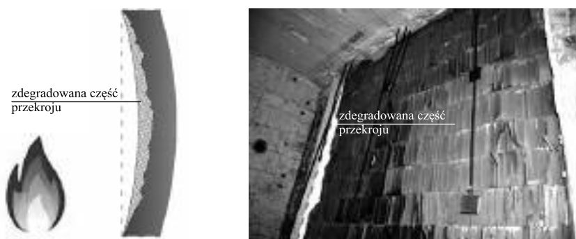
Rys. 4. Redukcja przekroju ściany w wyniku oddziaływania wysokiej temperatury Fig. 4. Reduction of the wall cross-section resulting from exposition to high temperature
