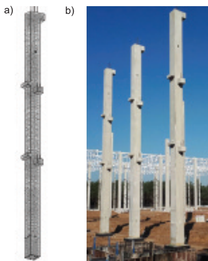
Fot. 4. Model prefabrykowanego słupa żelbetowego wykonany w programie REVIT (a); widok słupów z budowy (b)
