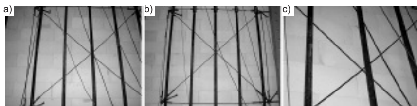
Rys. 4. Widok pierwszych widocznych zarysowań ścian serii HOS-AAC-2/3: a) ściana ścinana przy udziale wstępnych naprężeń ściskających \sigma_c = 0,1 N/mm 2 ; b) ściana ścinana przy udziale wstępnych naprężeń ściskających \sigma_c = 0,75 N/mm 2 ; c) ściana ścinana przy udziale wstępnych naprężeń ściskających \sigma_c = 1,0 N/mm 2
