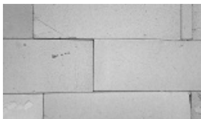
Przykład muru, w przypadku którego nie zastosowano się do zaleceń wykonawczych murowania na cienką spoinę
