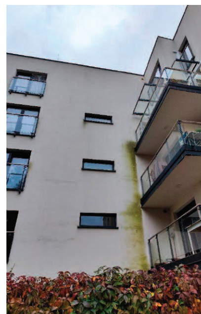
Fot. 2. Zacieki na elewacji
